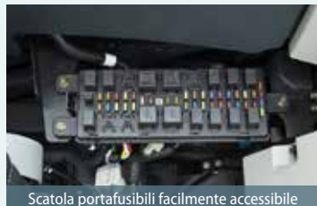
Scatola portafusibili facilmente accessibile
